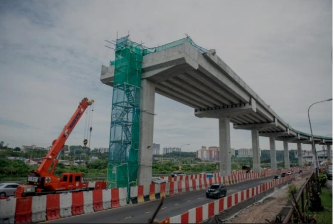
Keadaan semasa lokasi kejadian kepingan konkrit terjatuh daripada struktur binaan lebuh raya itu dan menghempap sebuah kereta petang semalam ketika tinjauan hari ini. FOTO BERNAMA
